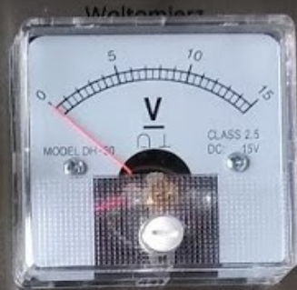
Napięcie na AQ1
