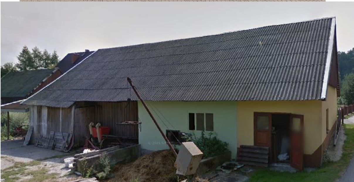
Rys. 6 Azbestowe pokrycia dachowe we wsi Krzczonów ( Google Street View )
