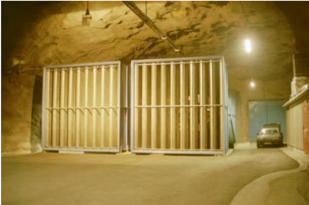
Rys. 0.3. Stacja uzdatniania powietrza w tunelu.
