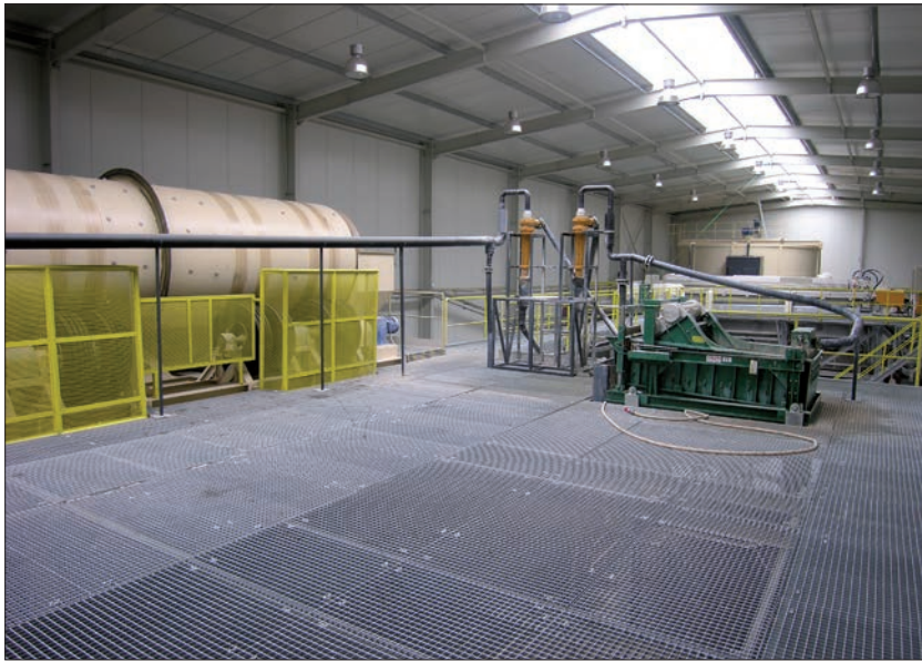
Fot. 7.7. Bolesławieckie Zakłady Materiałów Ogniotrwałych. Zakład przerobczy surowców ilastych Czerwona Woda (Dolny Śląsk). Stan z 2006 r.
