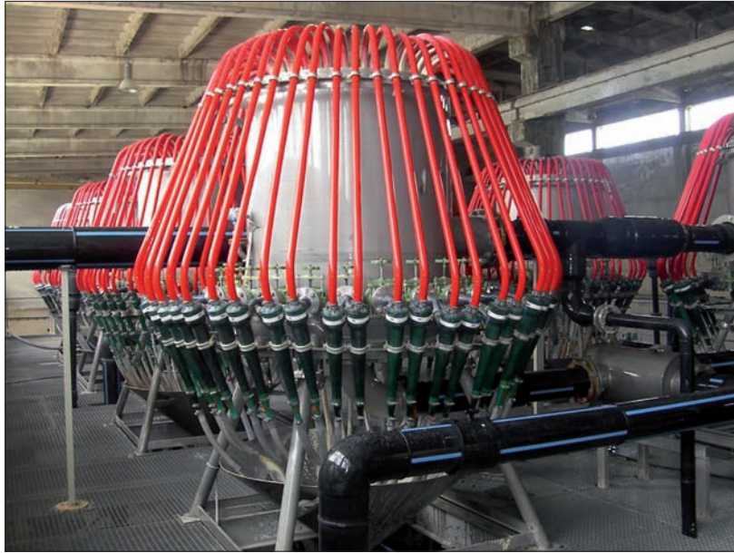
Fot. 7.5. KSM „Surmin-Kaolin” . Hydrocyklony w zakładzie przeróbczym kaolinu w Nowogrodźcu (Dolny Śląsk). Stan z 2005 r.
