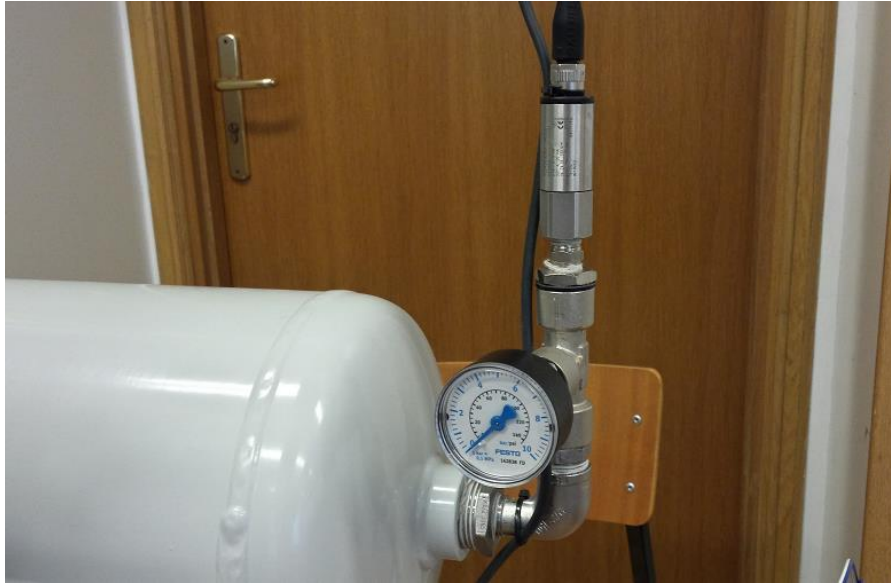
Rysunek 2.1.3: Przetwornik ciśnienia TURCK zainstalowany na obiekcie, źródło opracowanie własne.
