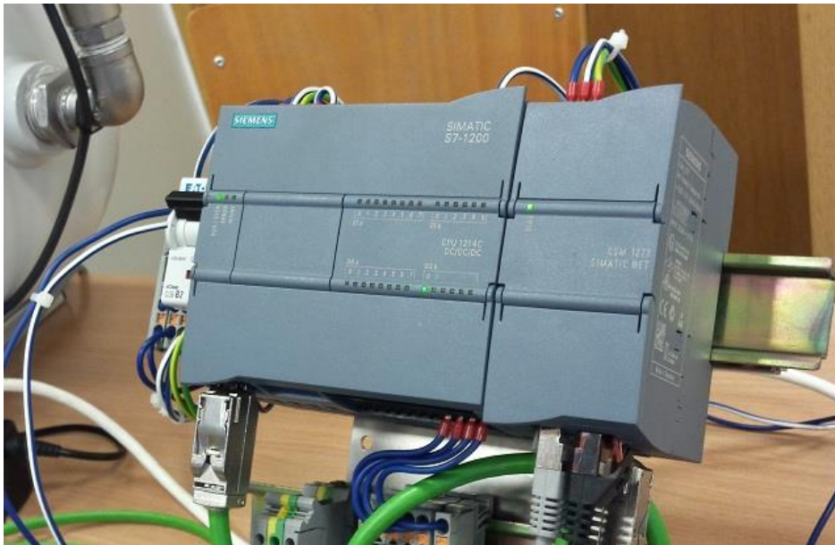
Rysunek 2.2.1 : Sterownik S7 1214 wraz z modulem CSM 1277 użyty do budowy stanowiska, źródło opracowanie własne.
