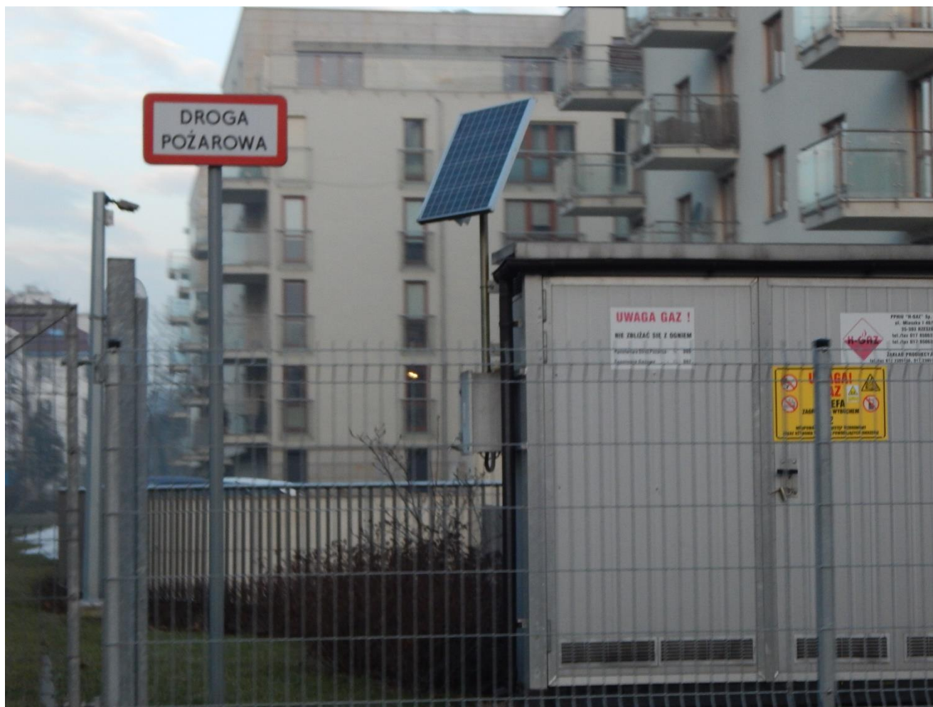
Stacja kontrolna instalacji gazowej. Kraków, ul Głowackiego
