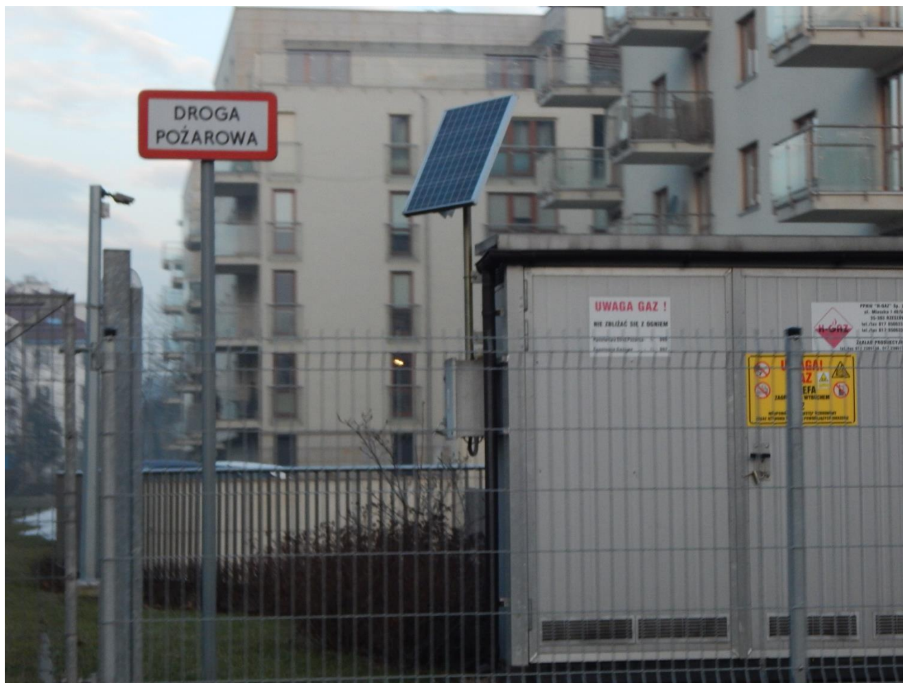
Stacja kontrolna instalacji gazowej. Kraków, ul Głowackiego
