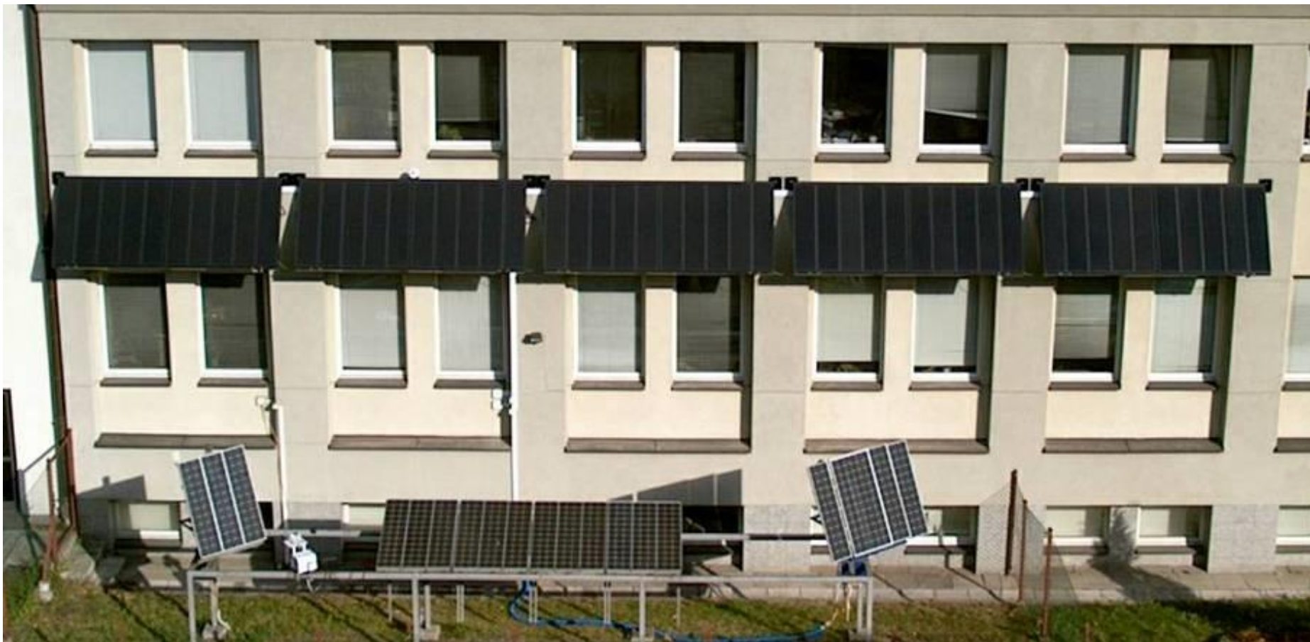
Fotowoltaiczny system zacieleniowy (markiza) AGH Budynek C-3
