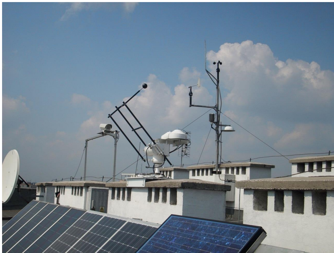
Stacja meteo na dachu budynku C3, Akademia Górniczo-Hutnicza, Kraków
