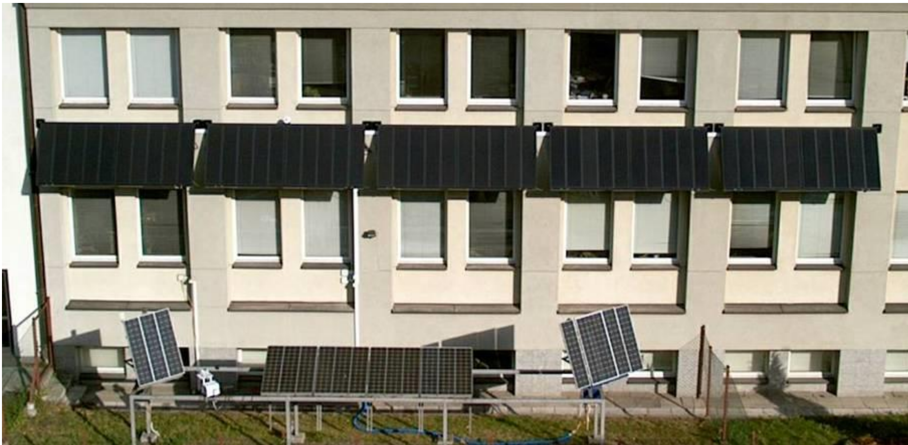
Fotowoltaiczny system zacieleniowy (markiza) AGH Budynek C-3
