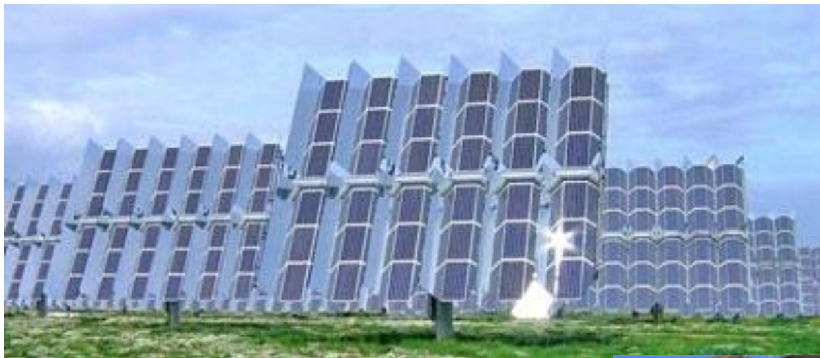
Sevilla PV PLANT (płaskie lustra)
