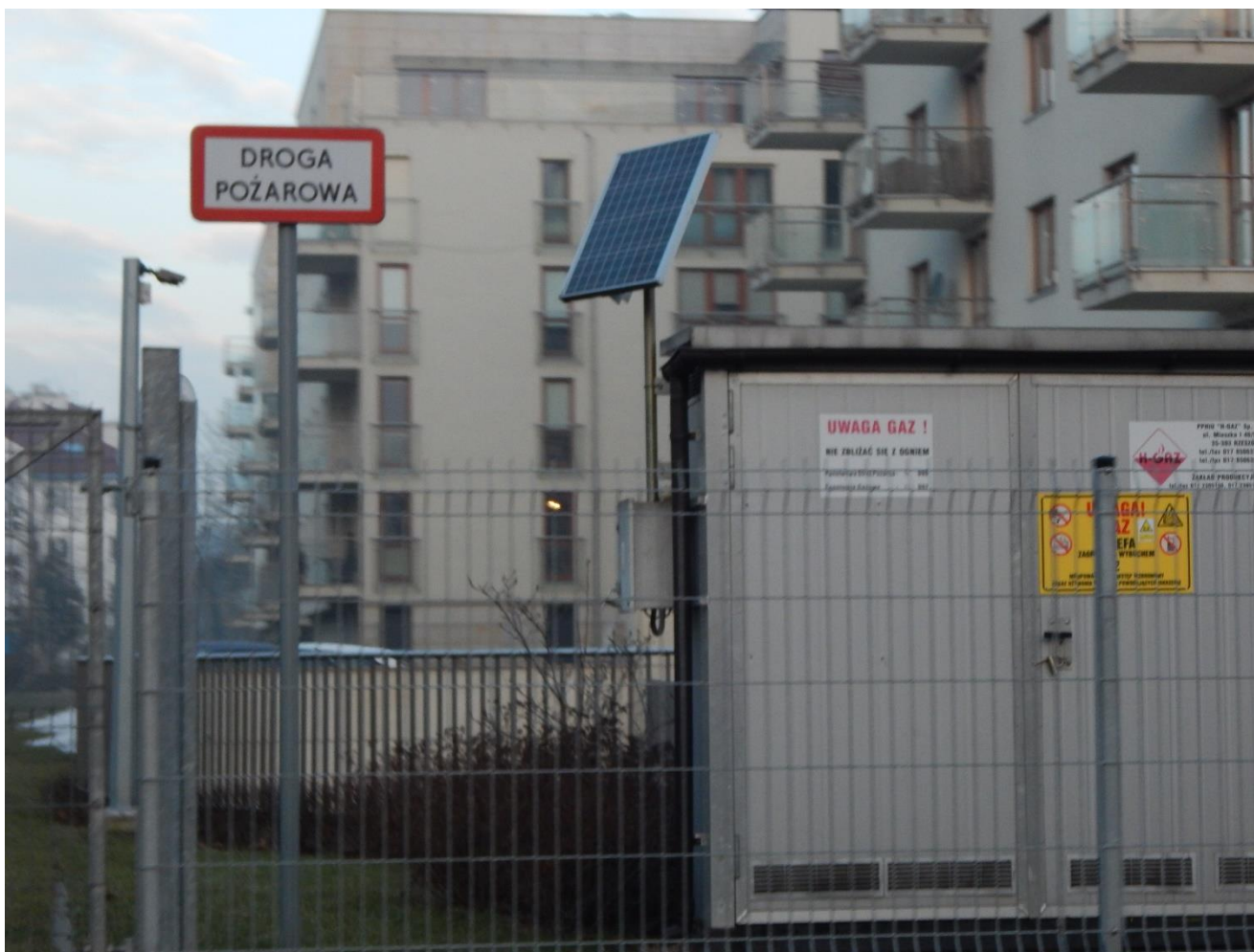
Stacja kontrolna instalacji gazowej. Kraków, ul Głowackiego
