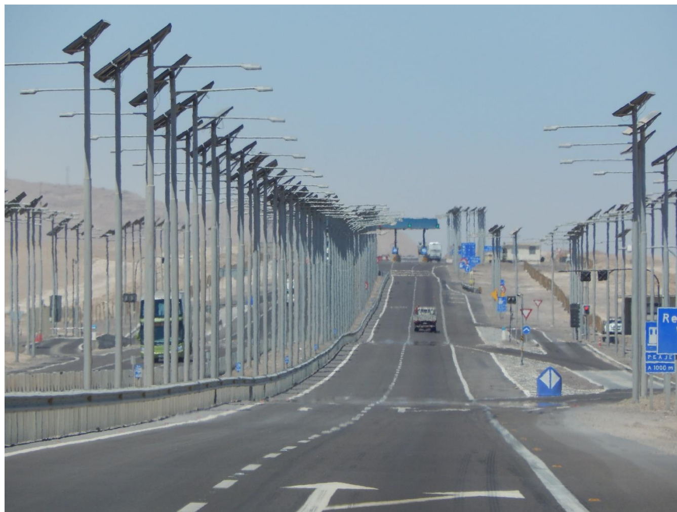
Oświetlenie węzła autostradowego Pustynia Atacama, Chile
