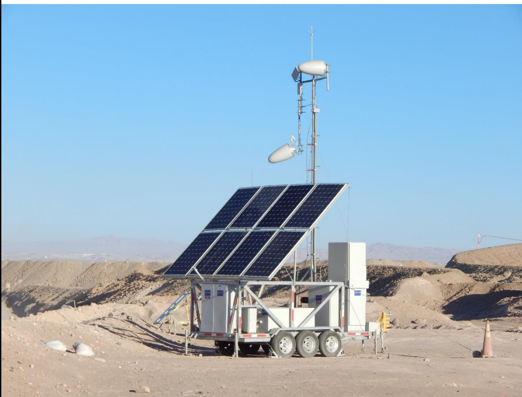
Stacje pomiarowe i radiokomunikacyjne w odkrywkowej kopalni miedzi KGHM Sierra Gorda, pustynia Atacama, Chile
