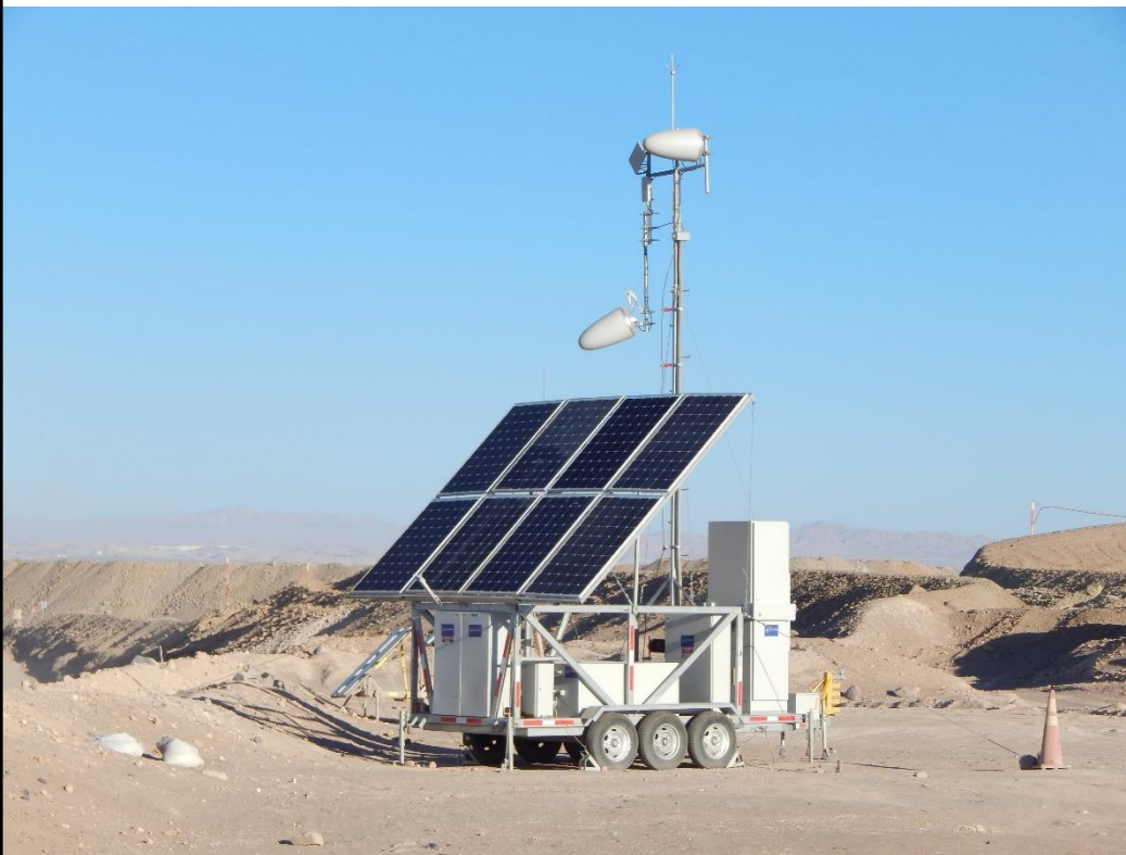
Stacje pomiarowe i radiokomunikacyjne w odkrywkowej kopalni miedzi KGHM Sierra Gorda, pustynia Atacama, Chile
