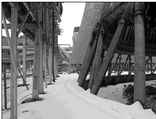
Rys. 1. Wyburzana chłodnia (po prawej) i chroniona estakada (po lewej)
